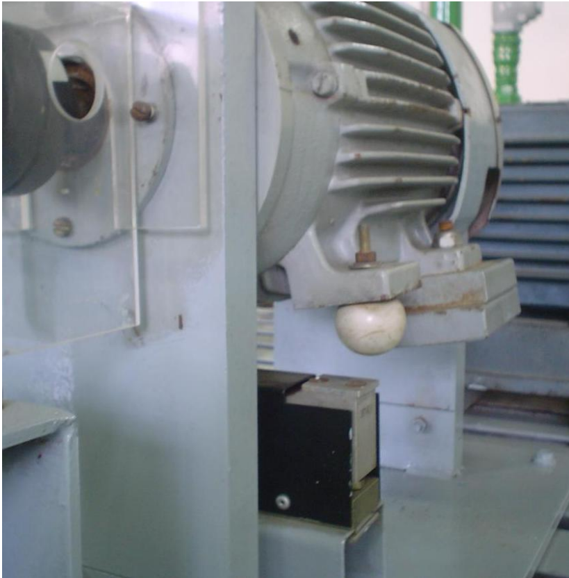
Não acionar o motor nessa situação
