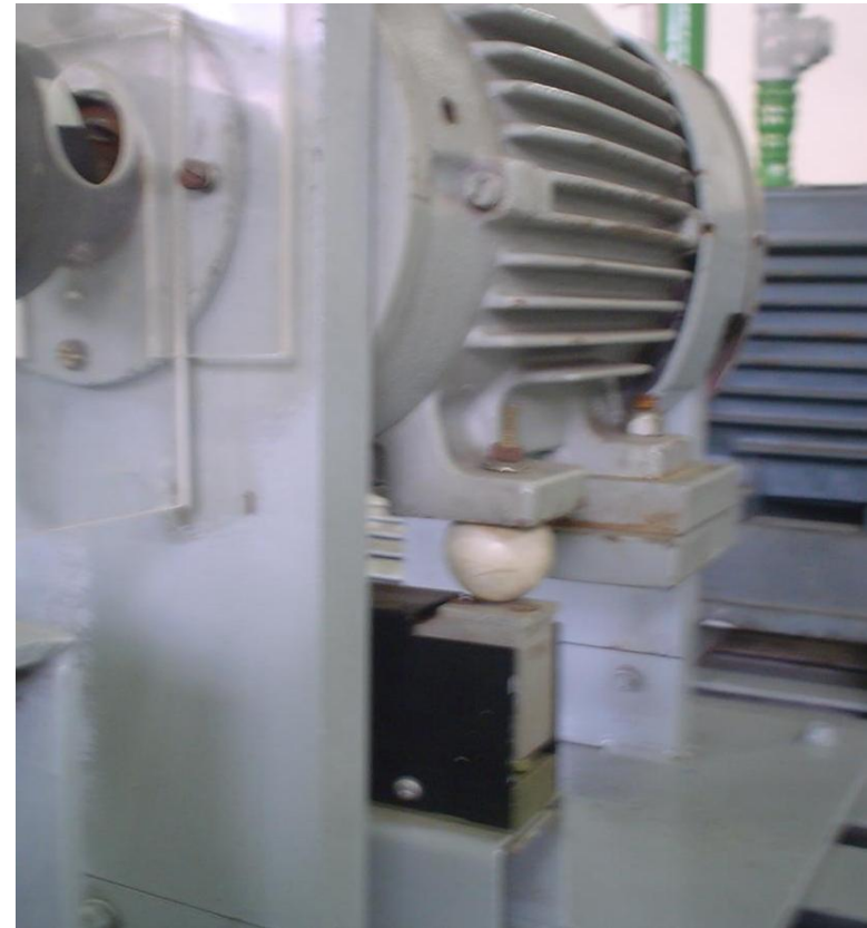
Acionar o motor só nessa situação
