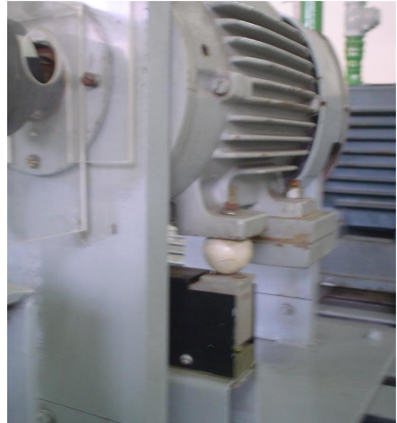
Acionar o motor só nessa situação
