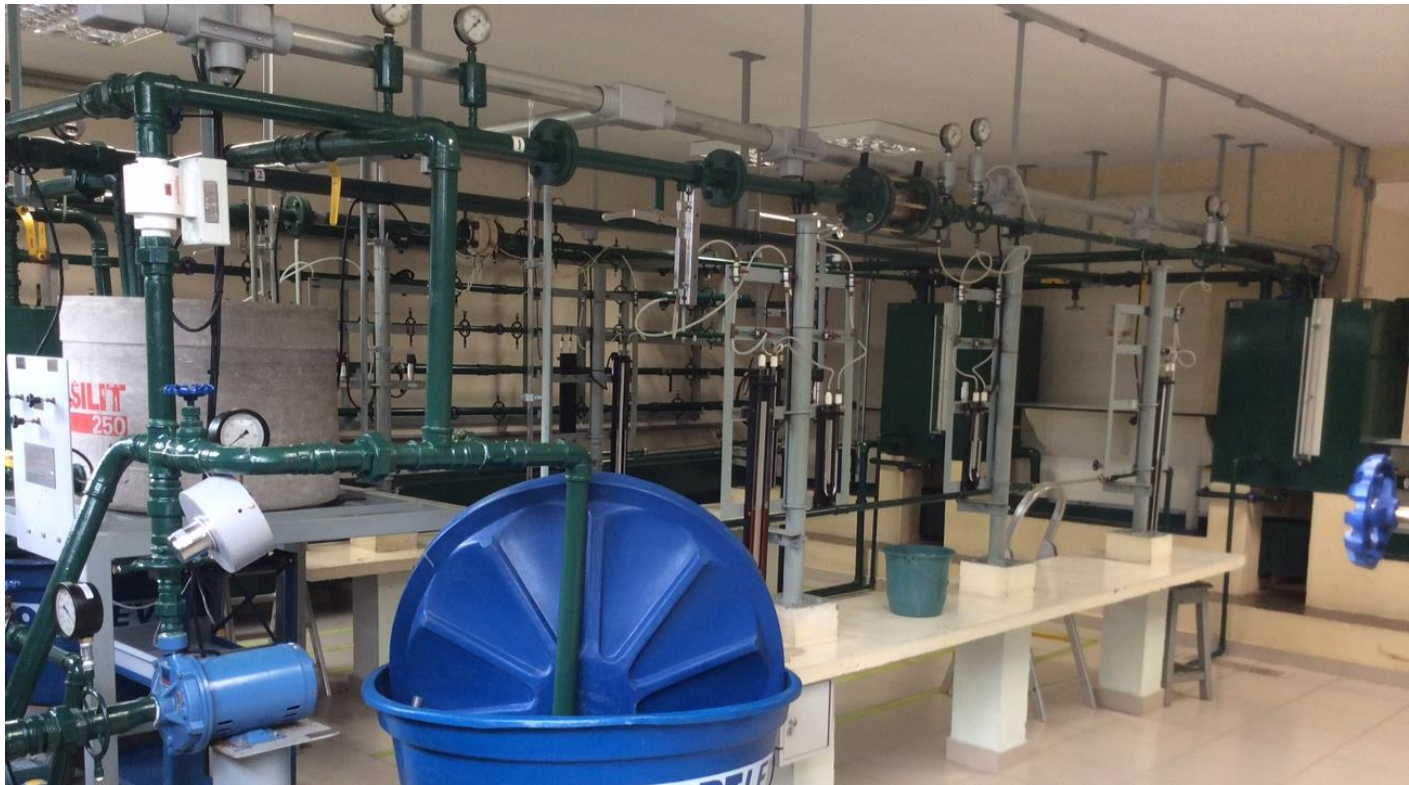
Bancada 7 do laboratório de Mecânica dos Flúídos do Centro Universitário da FEI
