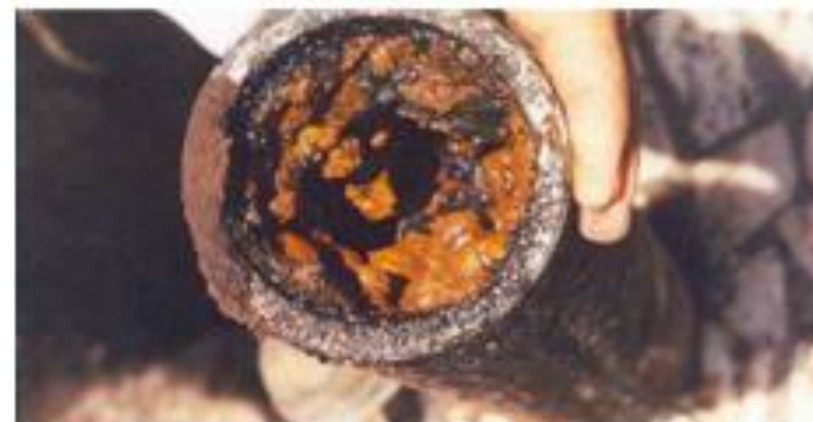
Amostra de incrustação na rede de ferro fundido cinzento
